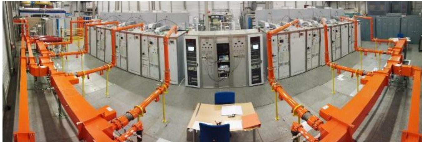
160 KW CW per Cavity
